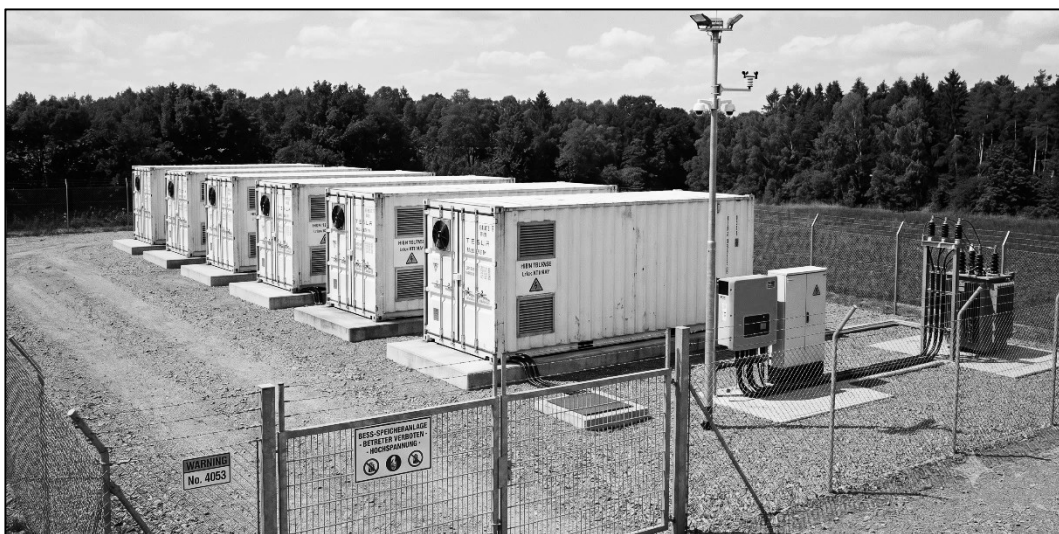
Abbildung 4: Beispielbild BESS-Anlage (KI-generiert)
