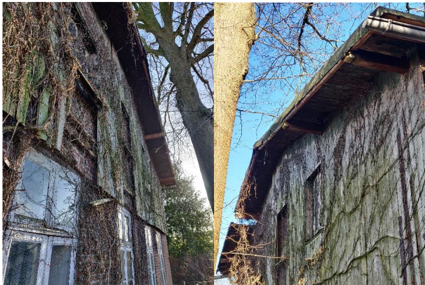
Abb. 3c: Abgängige Holzfassade, die ein potentielles Fledermausquartier darstellt.
