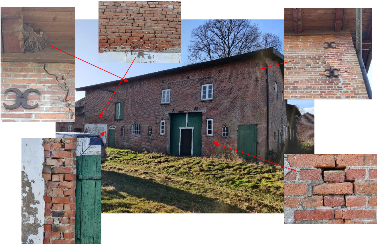
Abb. 3: Östliche Fassadenansicht mit Nest der Mehlschwalbe ( Delichon urbicum ) und diversen potentiellen Fledermausquartieren im maroden Mauerwerk (rote Pfeile).
