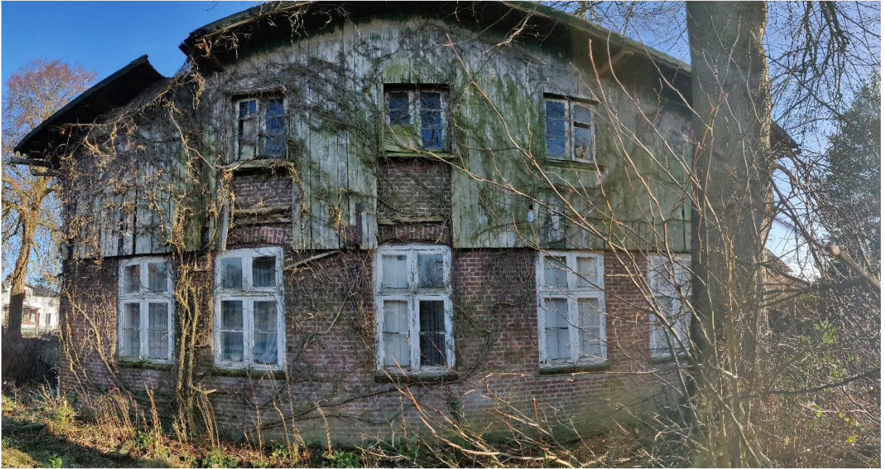
Abb. 3b: Panoramaaufnahme der Westseite des Wohngebäudes mit abgehängter Holzfassade, die ein potentielles Fledermausquartier darstellt.
