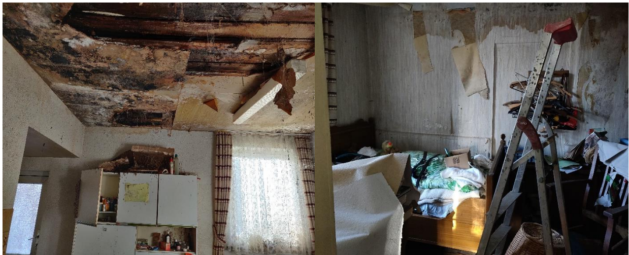
Abb. 2f: Blick in Küche (links) und Schlafzimmer (rechts). Starker Schimmelbefall und einstürzende Geschossdecken.
