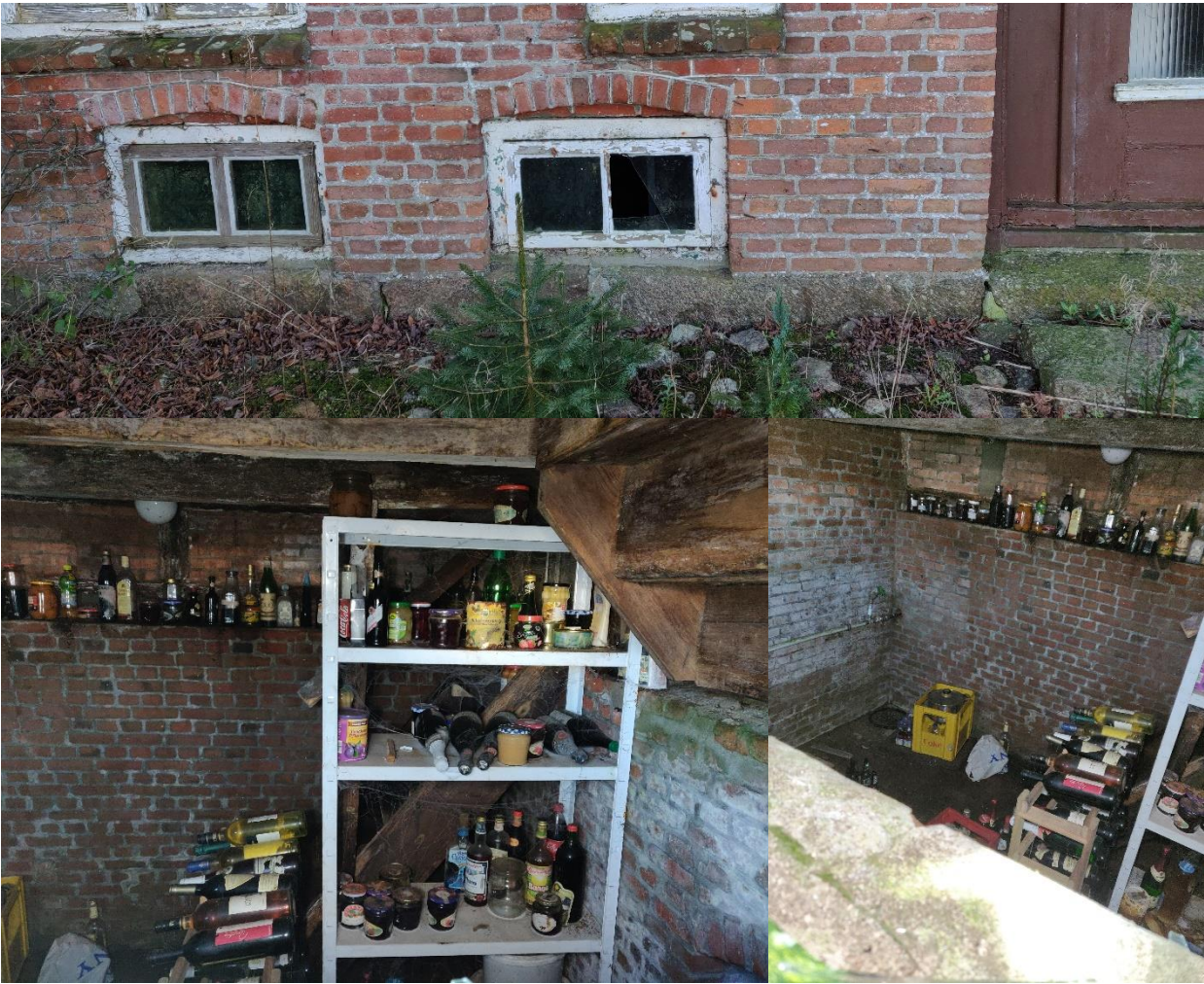
Abb. 2f: Kellerfenster neben der Eingangstür, oben. Blick in den Kellerraum von außen, unten. Der Zugang zum Keller war verschlossen und konnte nicht geöffnet werden.
