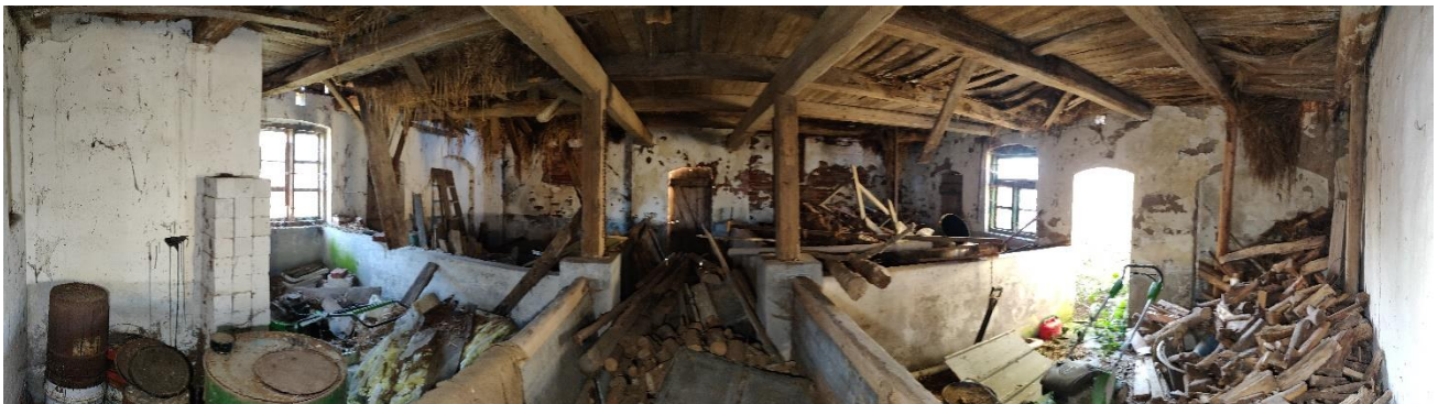
Abb. 2c: Panoramaaufnahme des hinteren Stallbereichs mit einstürzenden Geschosdecken und hohem Winterquartierpotential in Holzlagern .
