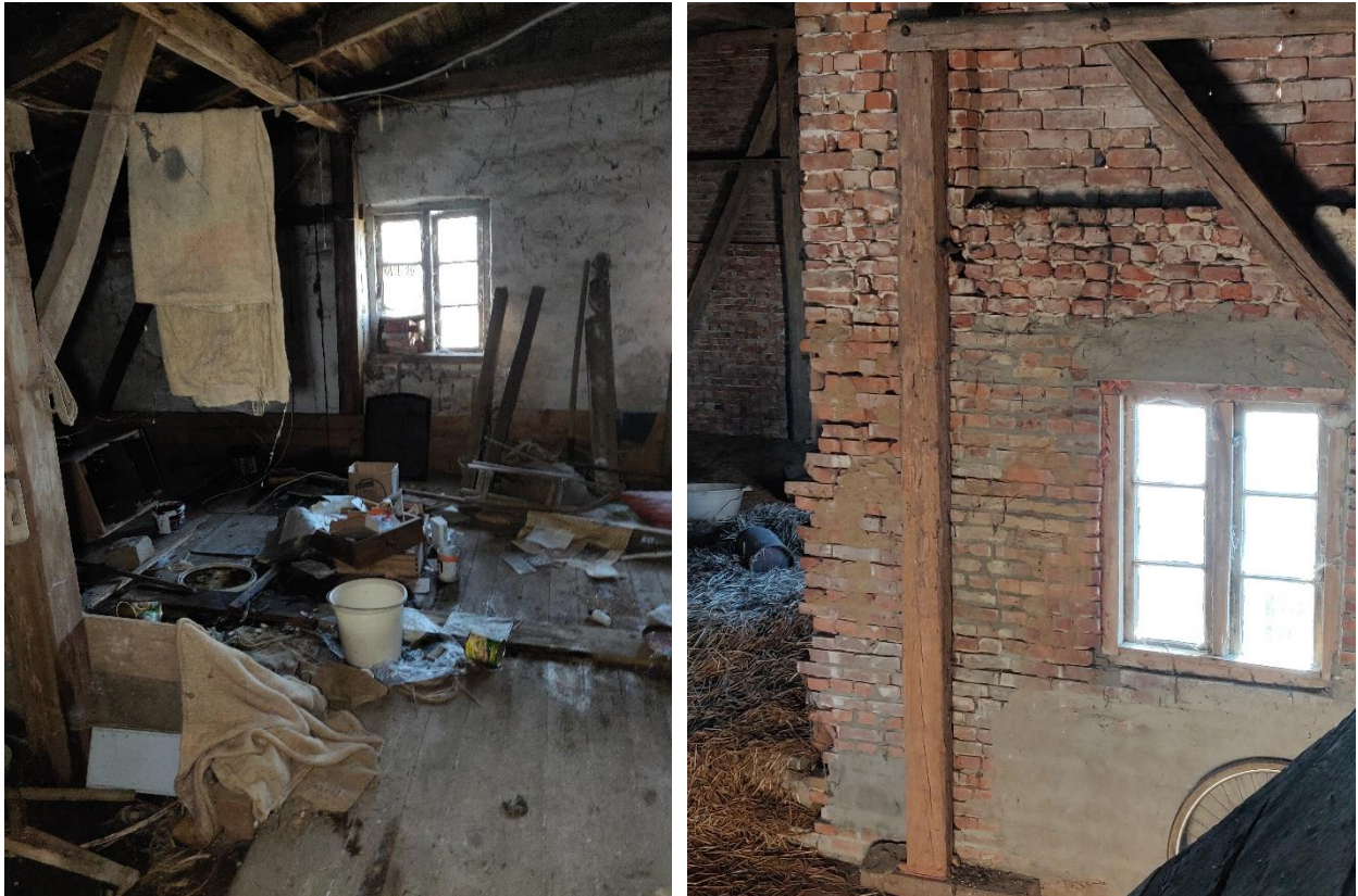
Abb. 2h: Blick in den Dachbodenbereich über dem Wohnbereich, links. Blick auf das spaltenreiche Mauerwerk der nach Süden ausgerichteten Dachbodenfassade, rechts.
