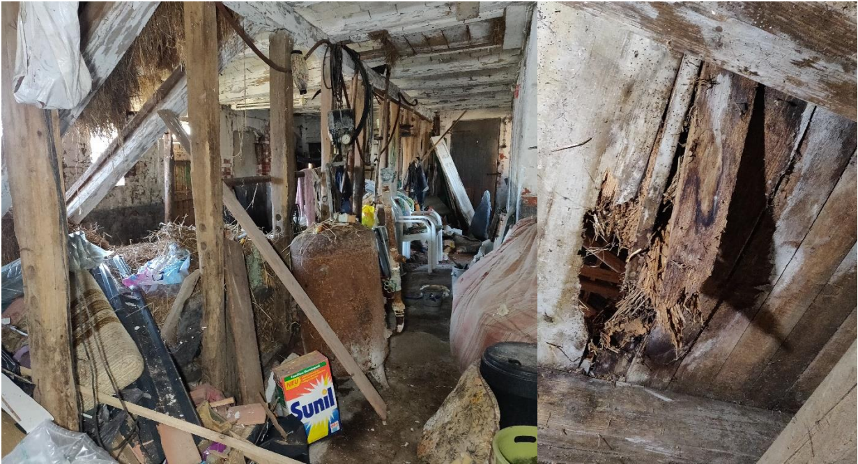
Abb. 2b: Blick in den Stall von der Tenne aus, links. Einstürzende Geschosdecke, rechts.
